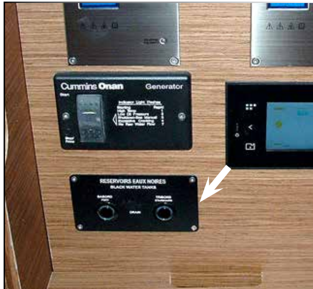
ENTLEERUNGSSCHALTER DER FÄKALIENTANKS
