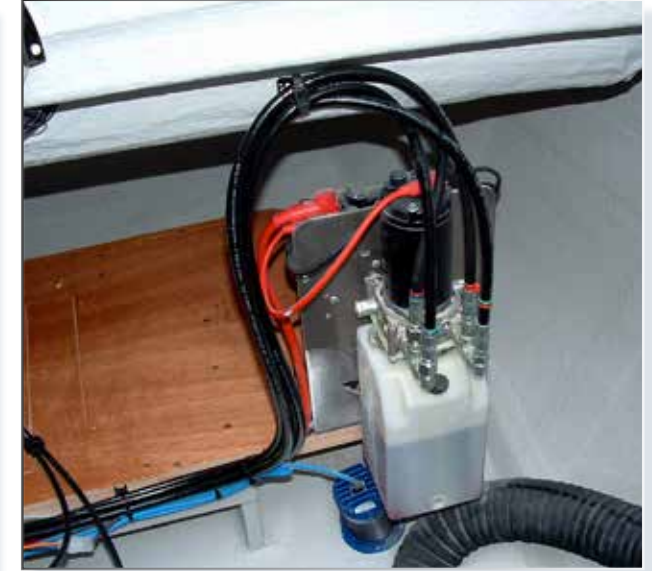
HYDRAULIKPUMPE DES TENDERLIFTS
