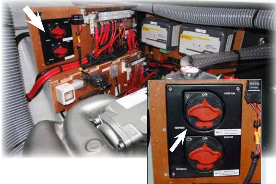
HAUPTSCHALTER IM STEUERBORD-MOTORRAUM
