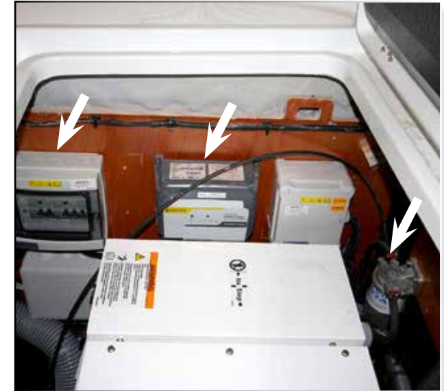
SCHUTZSCHALTER + LADEGERÄT + KRAFTSTOFFFILTER
