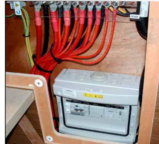
SCHUTZSCHALTER DES SPANNUNGSWANDLERS 12 V / 220 V - 2000 VA
