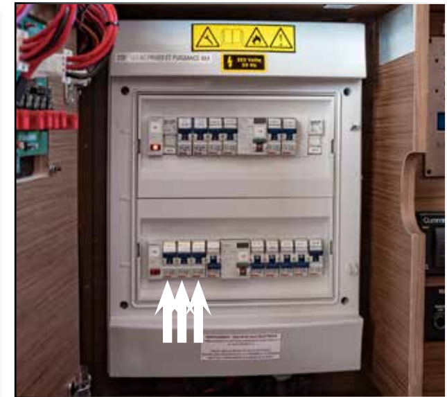
SCHUTZSCHALTER DER 12 V-BATTERIELADEGERÄTE
