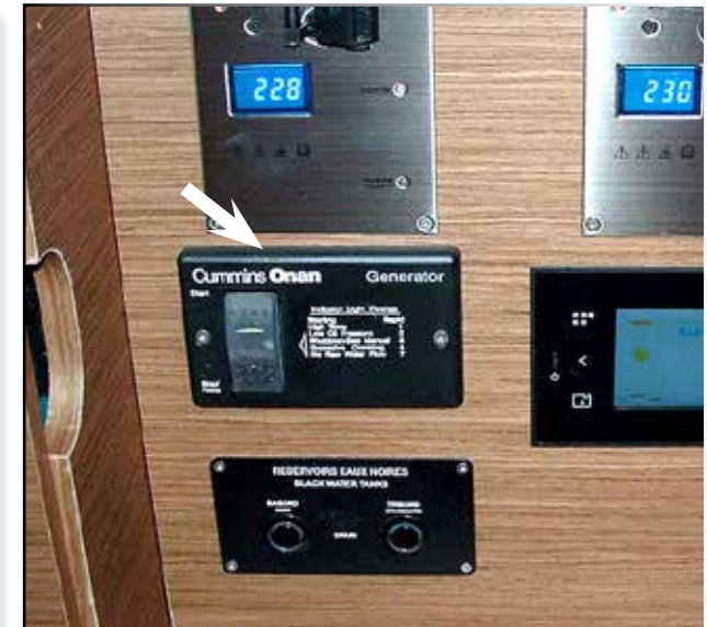
STEUERUNG DES GENERATORS
