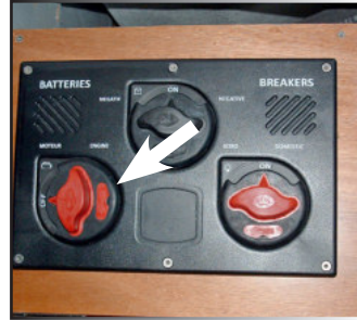
HAUPTSCHALTER MOTORBATTERIE BACKBORD
