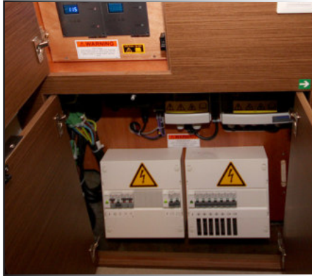
SICHERUNGSAUTOMATEN DER VERBRAUCHER
