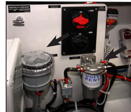
WASSERFILTER + KRAFTSTOFFFILTER + HAUPTSCHALTER
