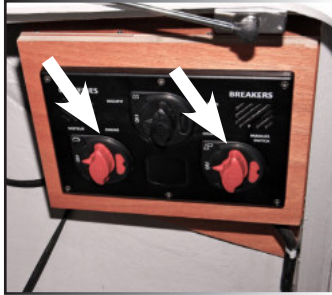
HAUPTSCHALTER MOTORBATTERIE STEUERBORD + KOPPELVORRICHTUNG
