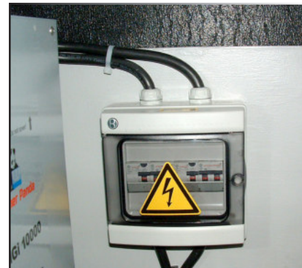
SCHUTZSCHALTER DES GENERATORS
