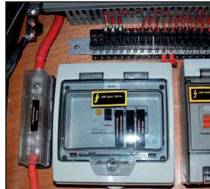
SICHERUNGSAUTOMATEN DER VERBRAUCHER
