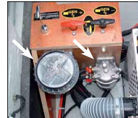
WASSERFILTER + KRAFTSTOFFFILTER DES GENERATORS
