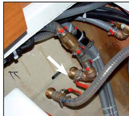
SEEWASSEREINLASS FÜR DEN GENERATOR
