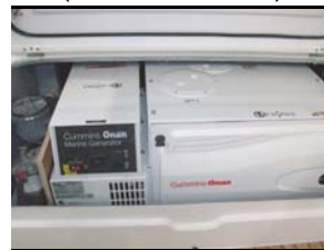
Generator + Meerwasserfilter + Dieselfilter (Kennnummer 5)
