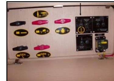
SCHUTZSCHALTER ANKERWINDE - 100A Kajüte hinten Backbord
