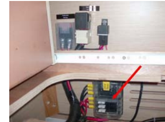
Installation: Kajüte hinten Backbord (Unter dem Bett) Pumpe - elektrisches WC (25A)
