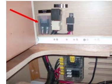
Installation: Kajüte hinten Backbord Selbststeuer - (60A)
