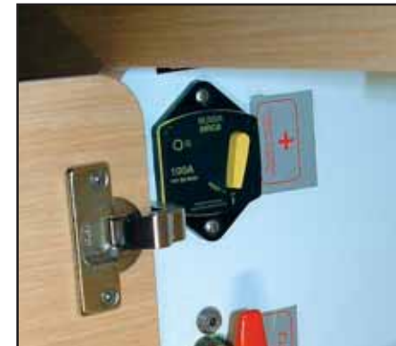
SCHUTZSCHALTER ANKERWINDE (ACHTERKABINE BB)
